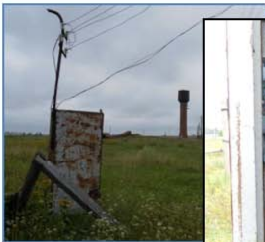
Башня Рожновского, щит управления насосной станцией
