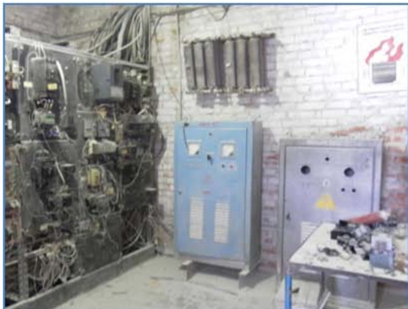
Электрощиты старой системы
