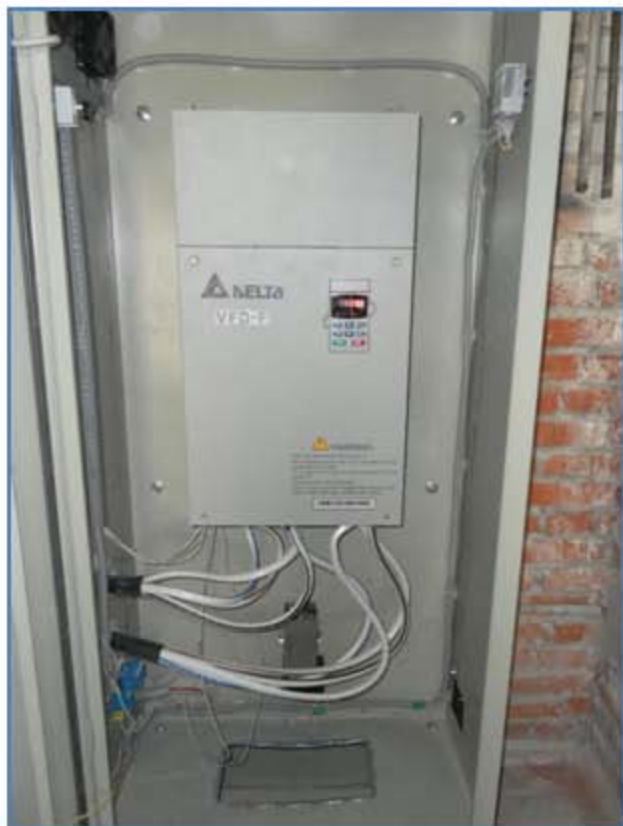
Шкаф управления с ПЧ
