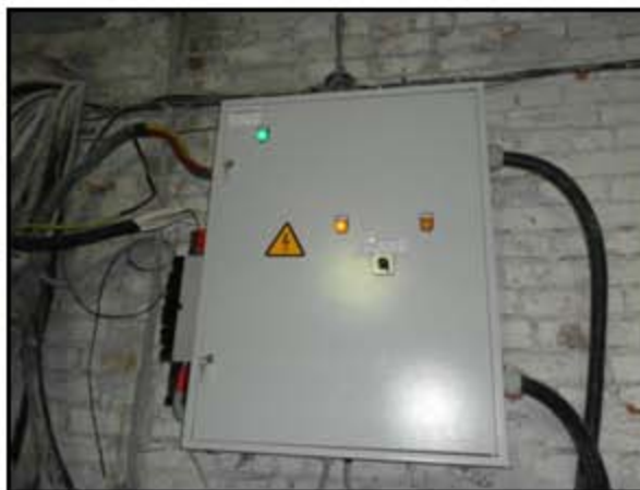
Шкаф силовой автоматики
