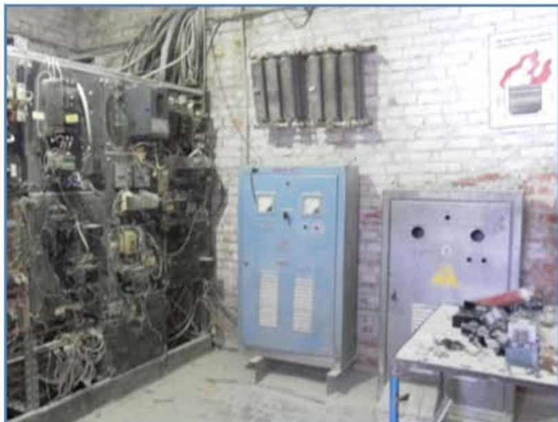
Электрощиты старой системы
