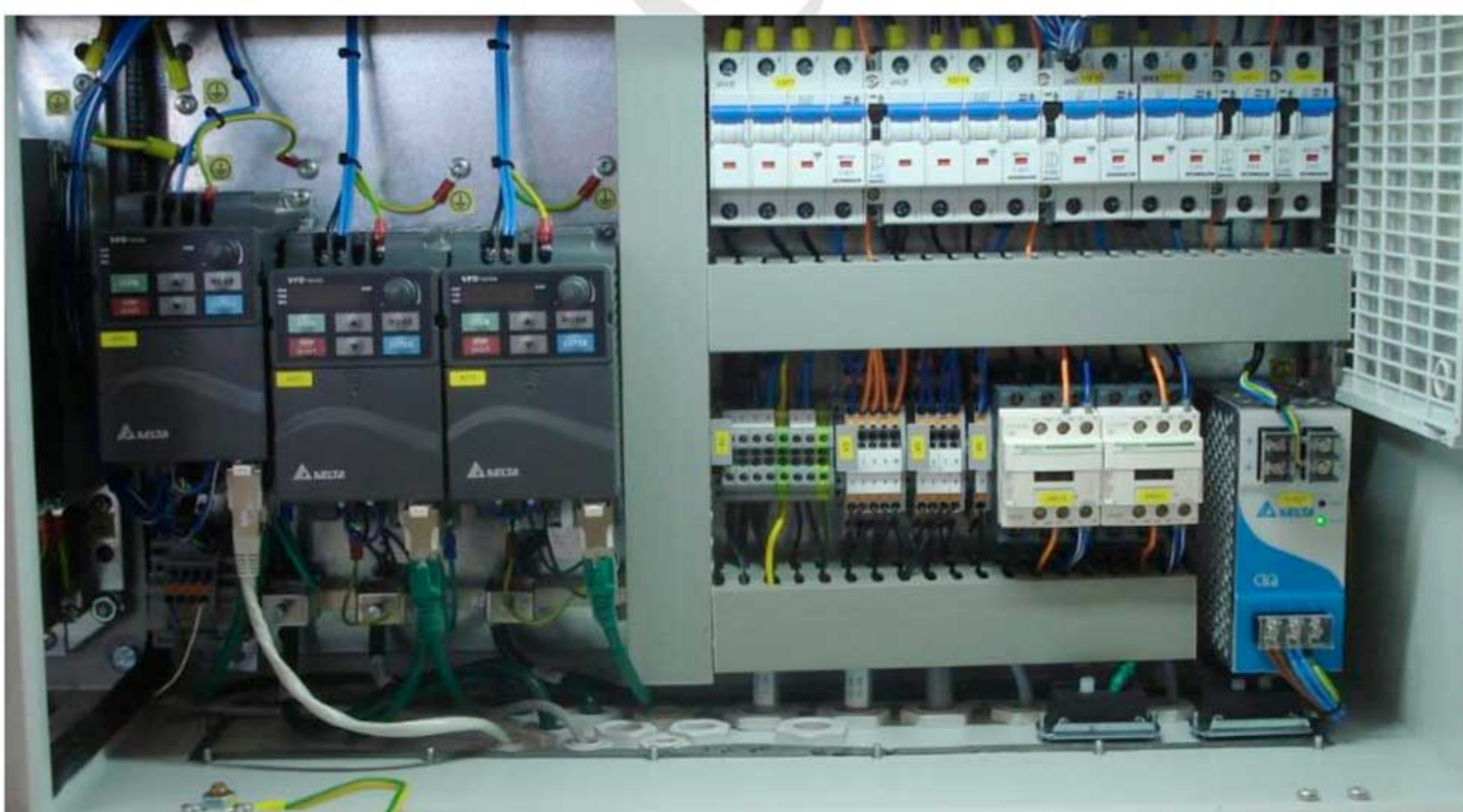
Рис. 4. Преобразователи частоты серии VFD-E и блоки питания серии DRP, установленные в шкафу управления.
