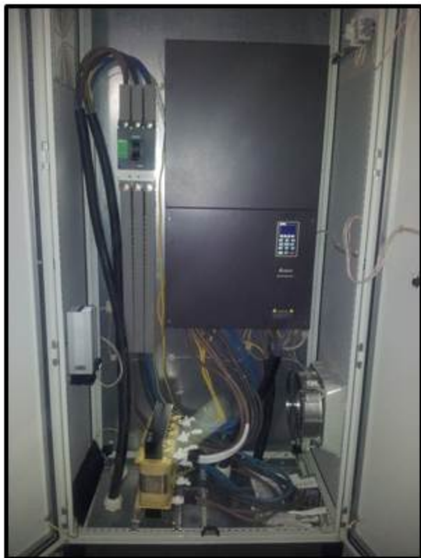
Шкаф управления насосом с ПЧ
