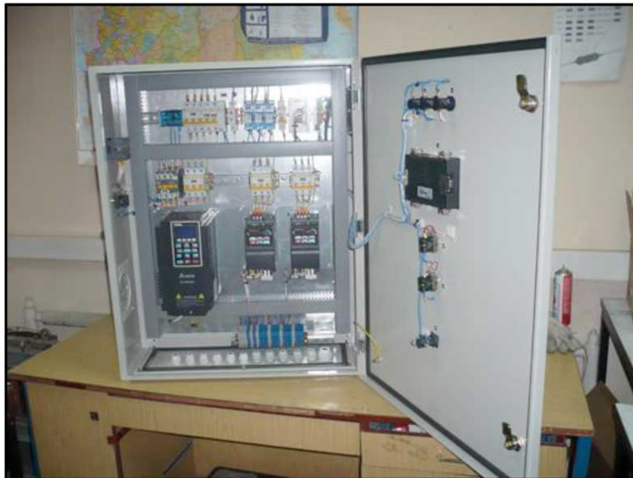
Оборудование Delta в шкафу управления: ПЧ VFD-C2000 и VFD-EL
