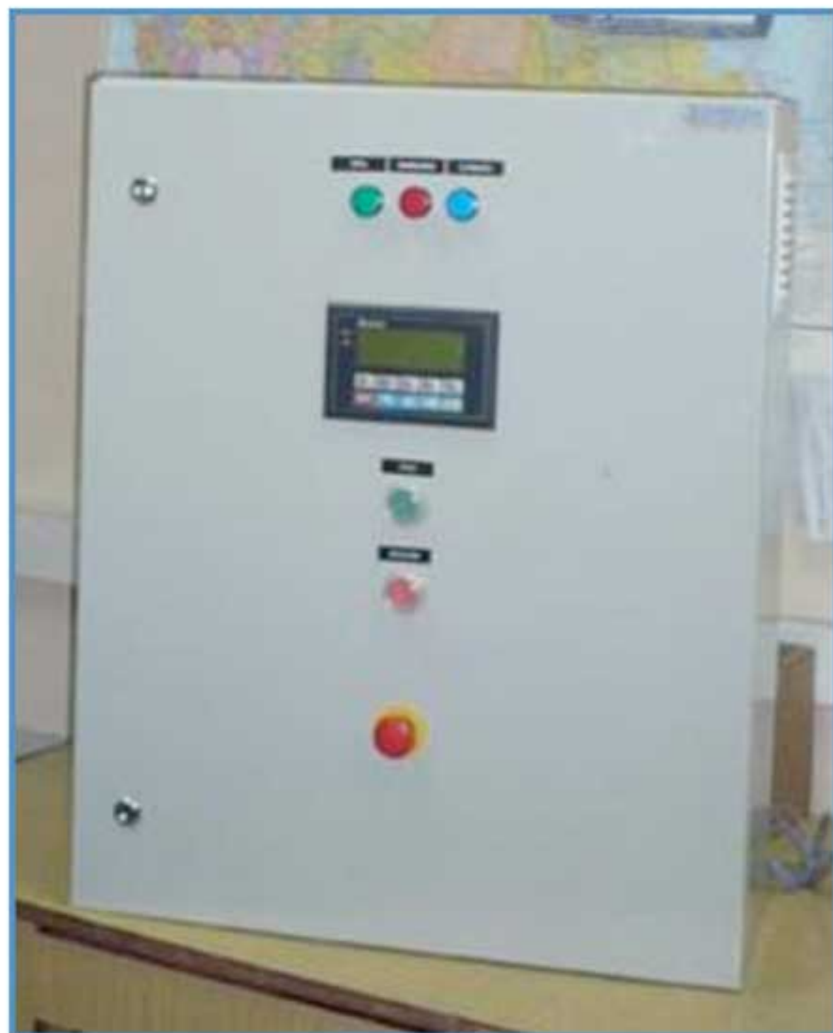
Лицевая панель шкафа управления (панель оператора Delta TP04G-AL2)
