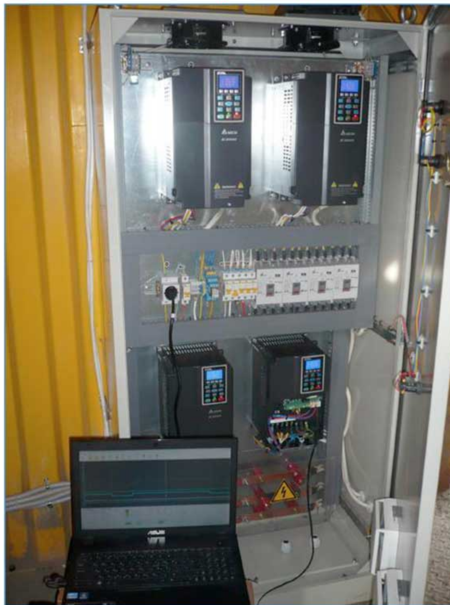
Преобразователи частоты VFD-C2000 в шкафу управления
