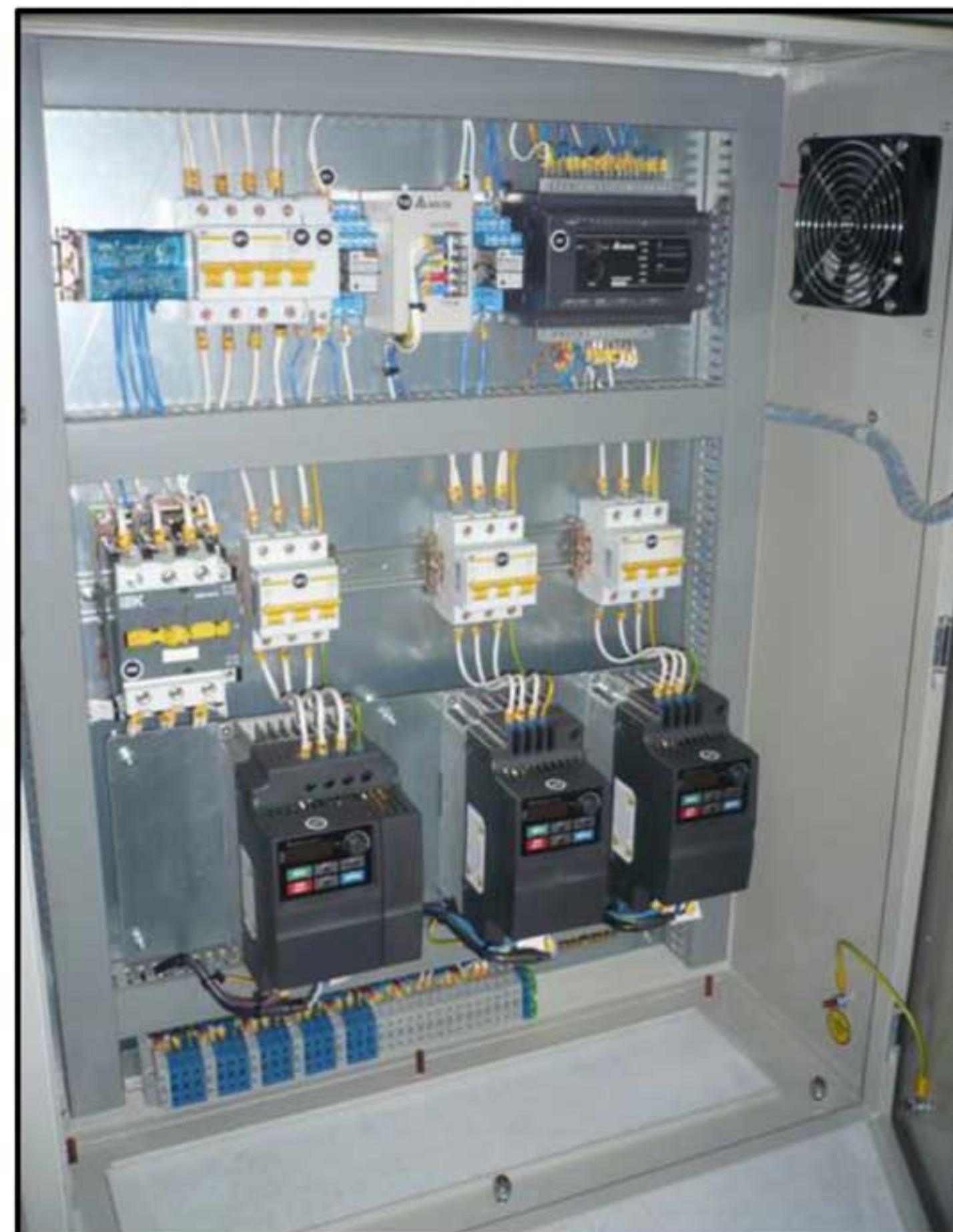
Оборудование Delta в шкафу управления (преобразователи частоты VFD-EL (3 шт.), ПЛК DVP-ES2, блок питания DVP-PS02, панель оператора TP04G-AL2)
