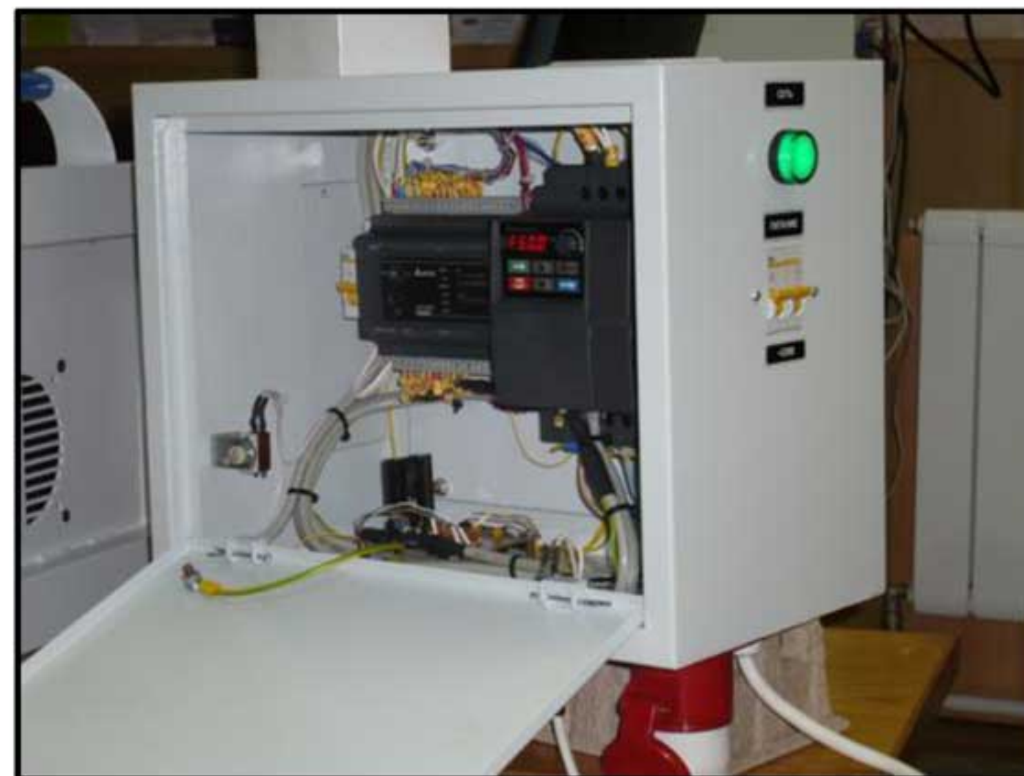
Оборудование Delta в шкафу управления ПЛК DVP-EX2 и преобразователь частоты VFD-EL
