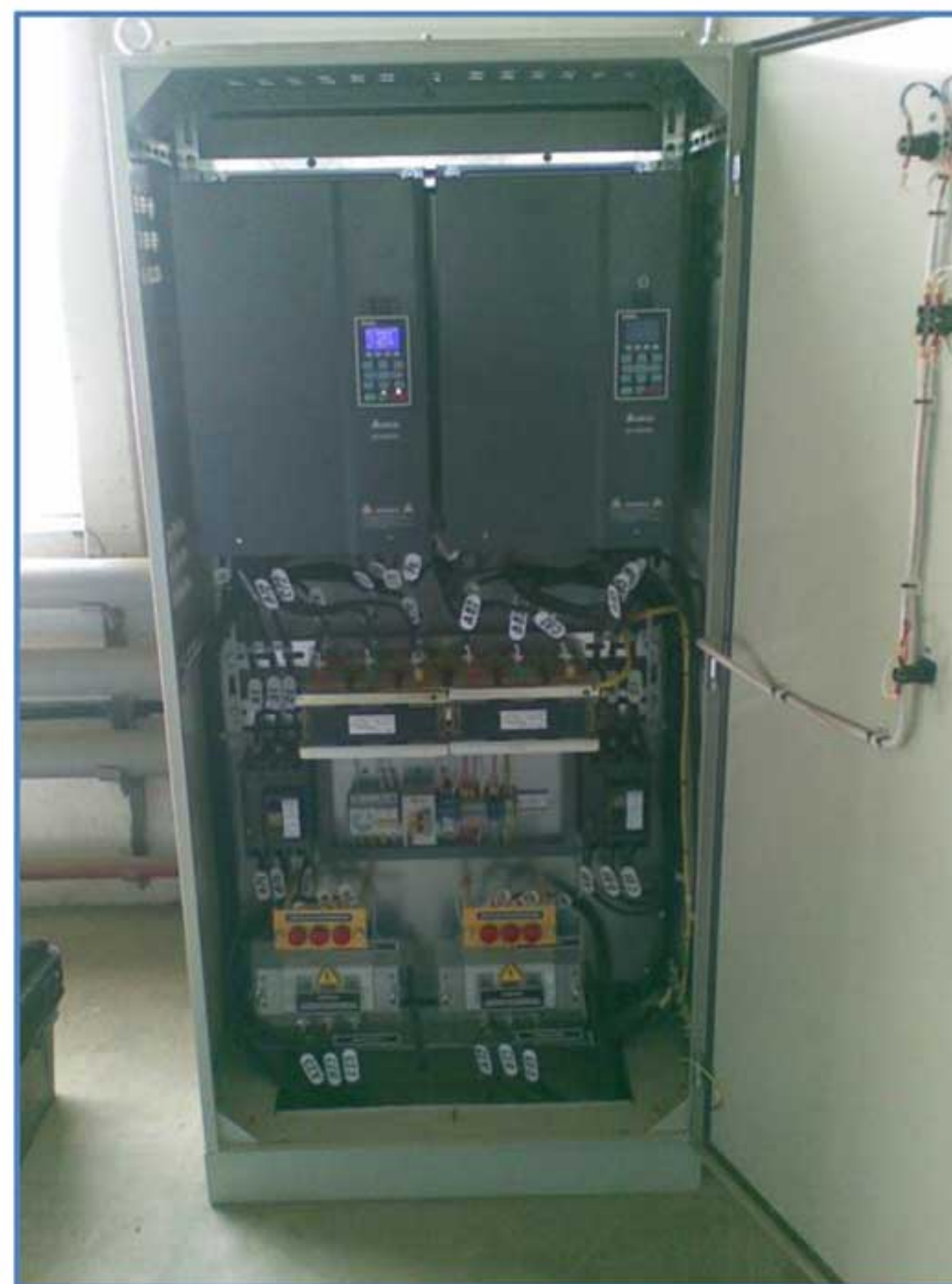
Оборудование Delta в шкафу управления ПЧ VFD370C43A – 2 шт.
