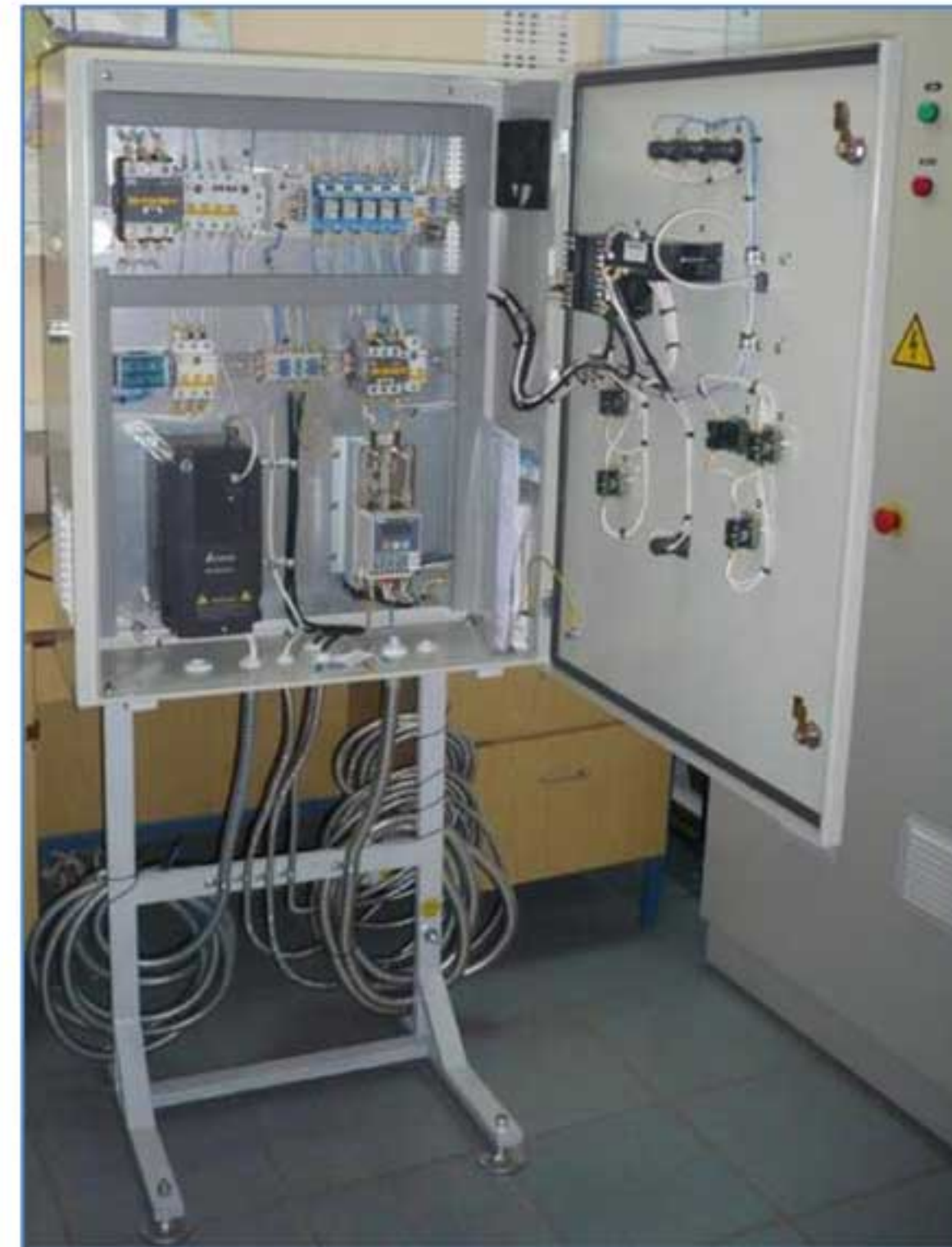
Оборудование Delta, Fotek в шкафу управления
