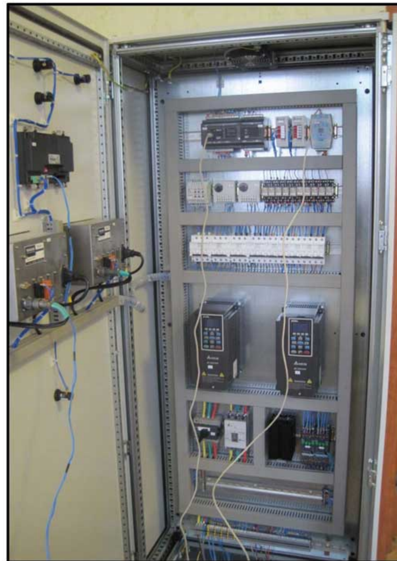
Преобразователи частоты VFD-C2000 в шкафу управления
