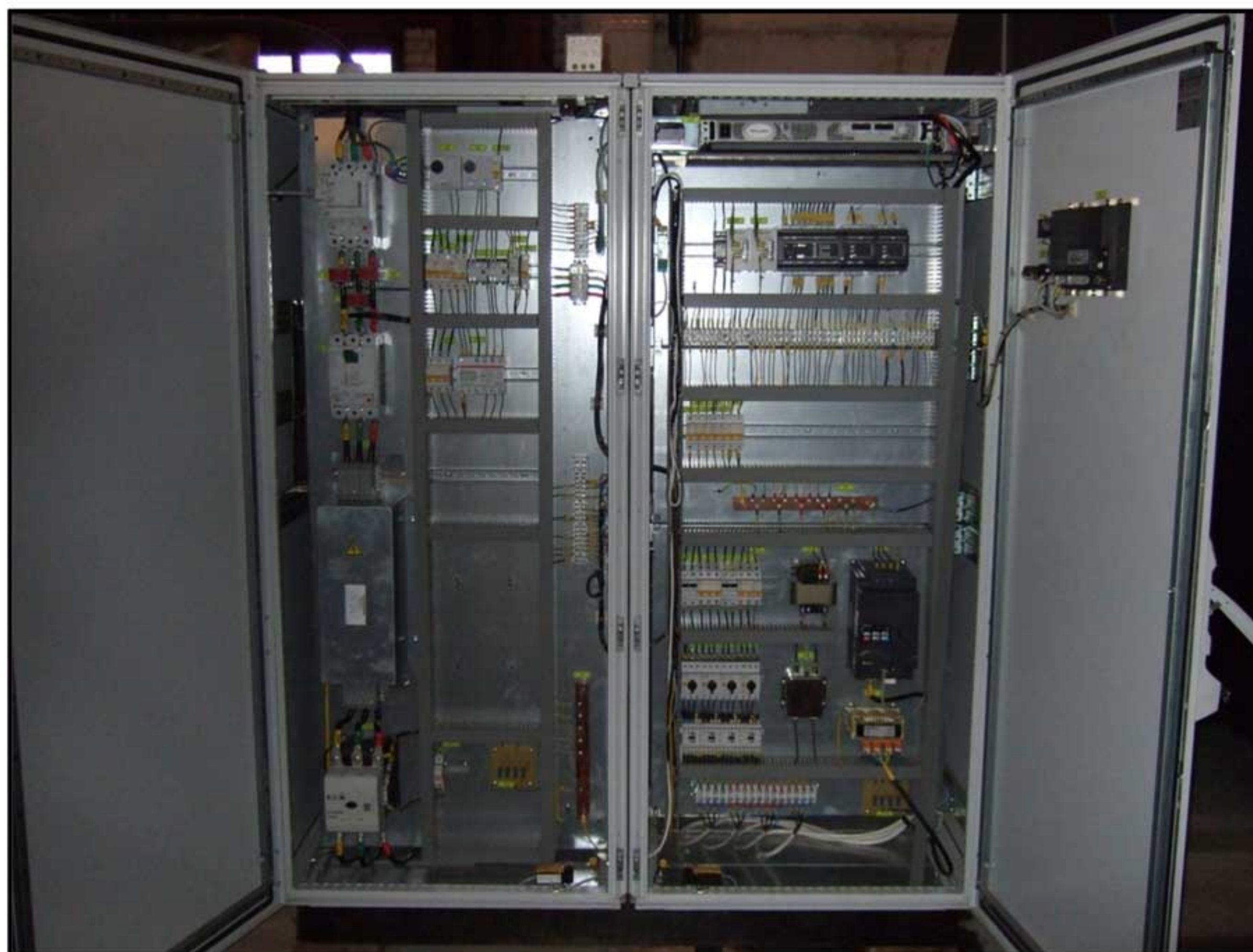
Шкаф управления (панель оператора заменена в ходе модернизации на DOP-B)
