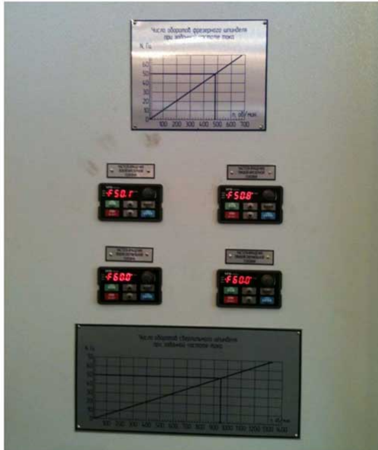
Пульты управления преобразователями частоты установлены на лицевой панели шкафа управления
