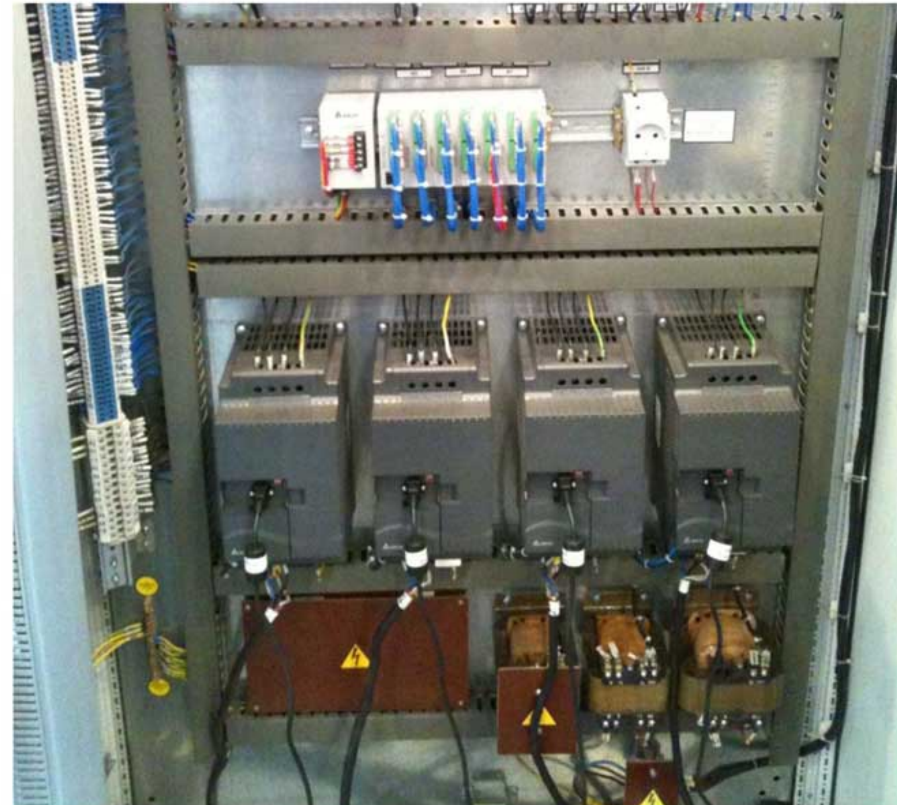
Шкаф управления станком
