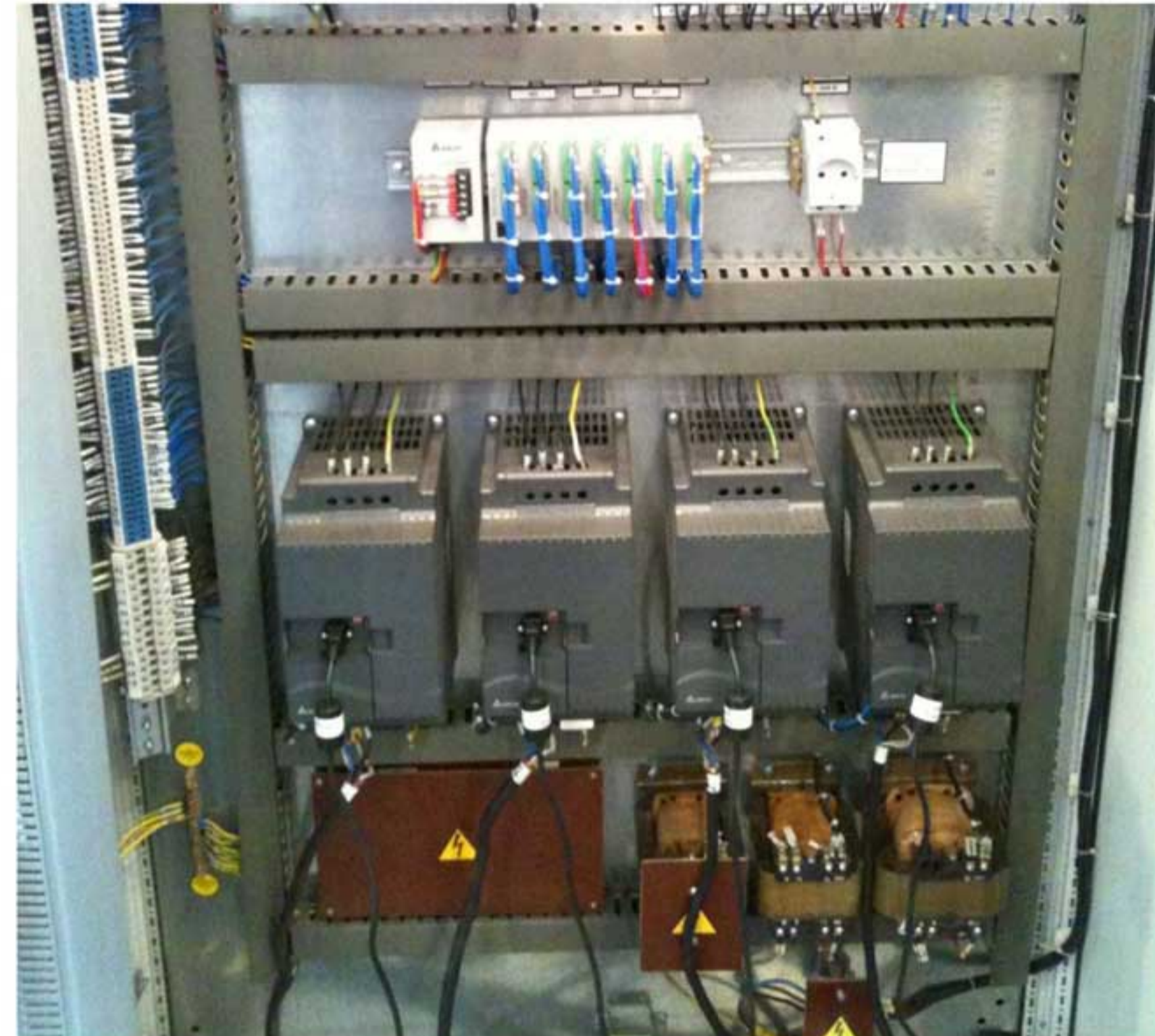
Шкаф управления станком
