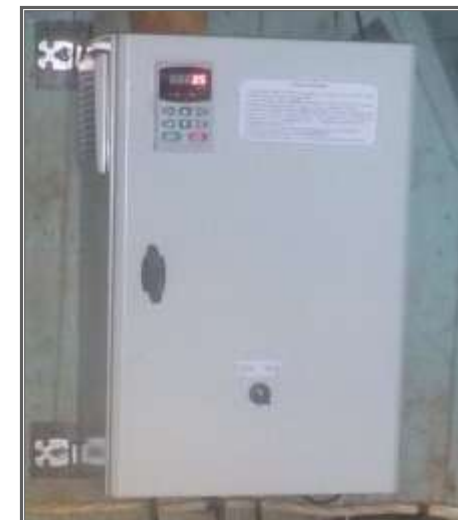
Внешний вид шкафа управления
